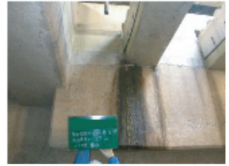
下水道処理槽内部漏水状況
